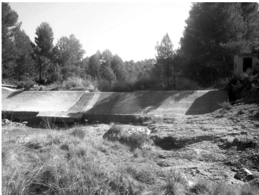
Figura 5. Presa o azud de derivación. Fuente: Diego García Monteagudo, 2011
