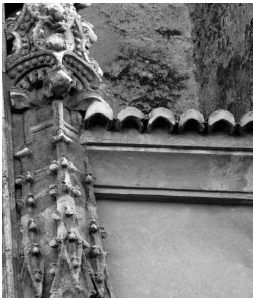
Imagen 32. Detalle de un fragmento del tejado, que en su totalidad se encuentra sellado, impidiendo su ocupación por los vencejos.
