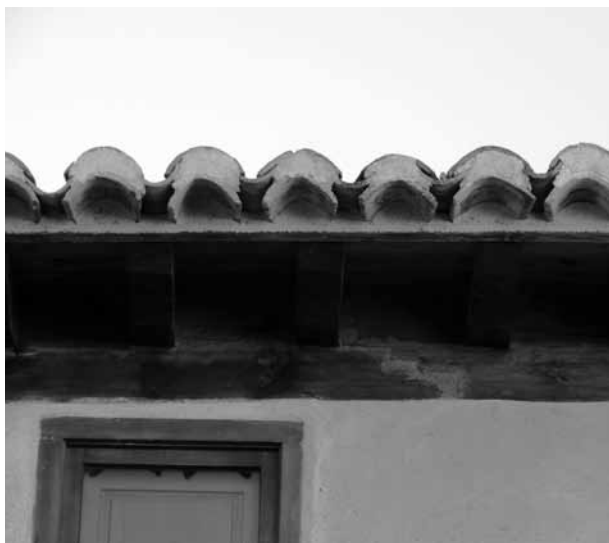
Imagen 34. Detalle del alero del tejado del edificio anterior, totalmente sellado e inviable para la nidificación del vencejo pálido.
