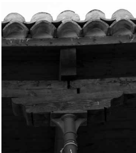
Imagen 30. Detalle de la nueva cubierta interior de dicha plaza. El sellado de todos sus huecos ha supuesto la desaparición de la práctica totalidad de la colonia de vencejos.
