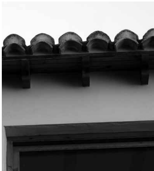
Imagen 26. Aspecto actual del alero del edificio anterior. Ha sido recientemente reformado y se han sellado con cemento los huecos bajo las tejas, resultando imposible su ocupación por los vencejos.
