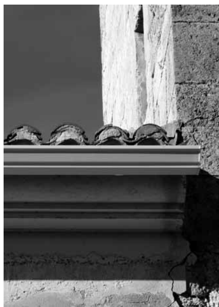
Imagen 44. Detalle del alero del edificio, en el cual se aprecian reformas relativamente recientes. No presenta huecos adecuados para la nidificación del vencejo pálido.
