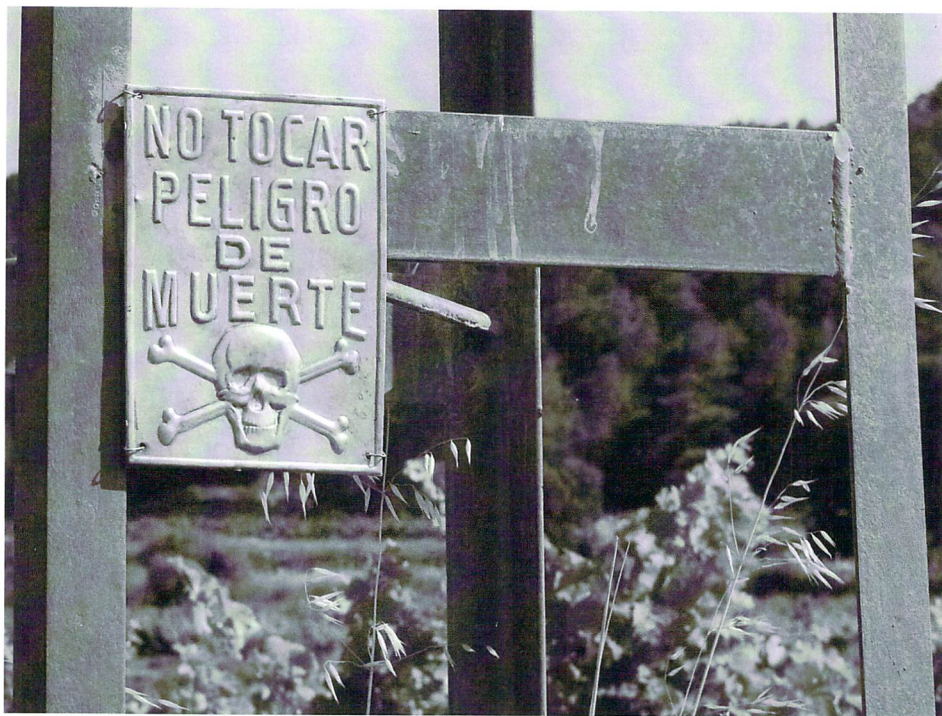
Imagen 1. Señal de advertencia de la alta peligrosidad de un tendido eléctrico.
