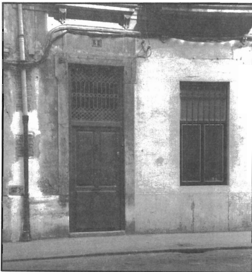
(Domicilio de la familia Pérez-Clemente en Valencia. Detalle del estado actual de la fachada. Foto 1985)
