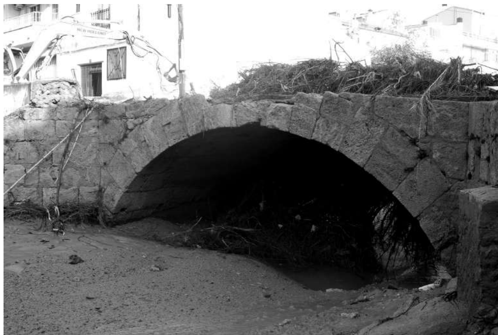
Estado del puente de las Ollerías tras el desbordamiento del regajo de Reinas en Requena (29 de octubre de 2024)
